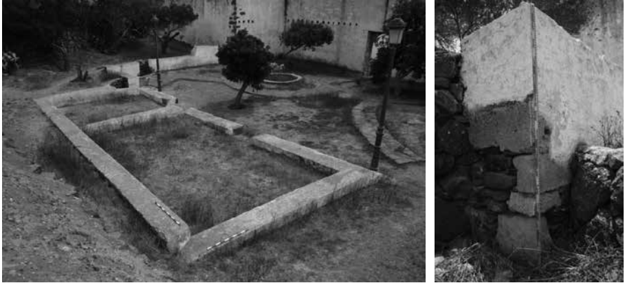
Fig. 5. Estado actual de la zona conventual con los muros fruto de las reformas realizadas en el siglo XX y detalle de uno de los muros reconstruidos.
